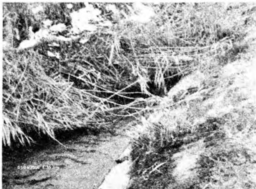
5.16 - расм. Бетон каналлар четини ўт босиши
